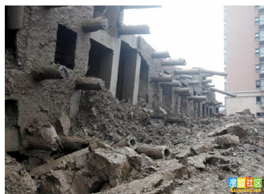
(b) 管桩桩身断裂
